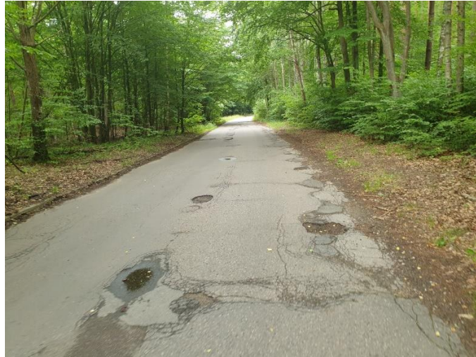
Rysunek 9. Ulica komandora. Sakowicza w kierunku jednostki wojskowej; po prawej stronie widoczny krawężnik, nawierzchnia zniszczona przez odpływającą wodę deszczową.
