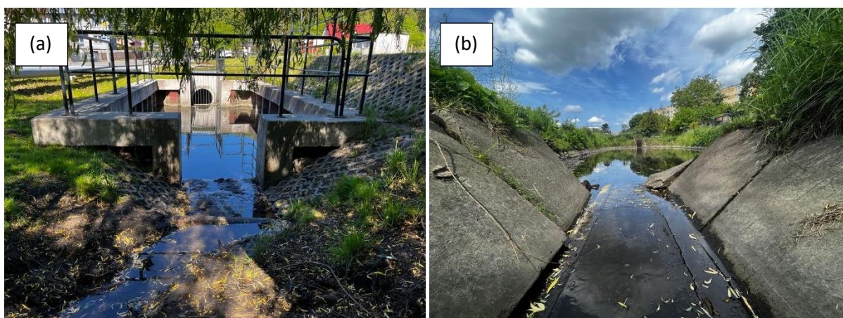
Rysunek 1. Budowle upustowo-zrzutowe; piaskownik przy ul. Sakowicza (a); piaskownik w rejonie ul. Chełmińskiej (b)
