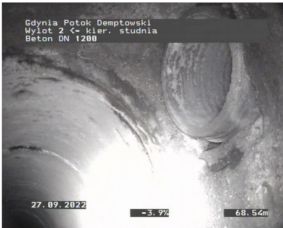
Rysunek 35. Komora na połączeniu rurociągu \varnothing 1000 i \varnothing 1200 – komora znajduje się w pasie zieleni pomiędzy jezdniami obwodnicy trójmiejskiej
