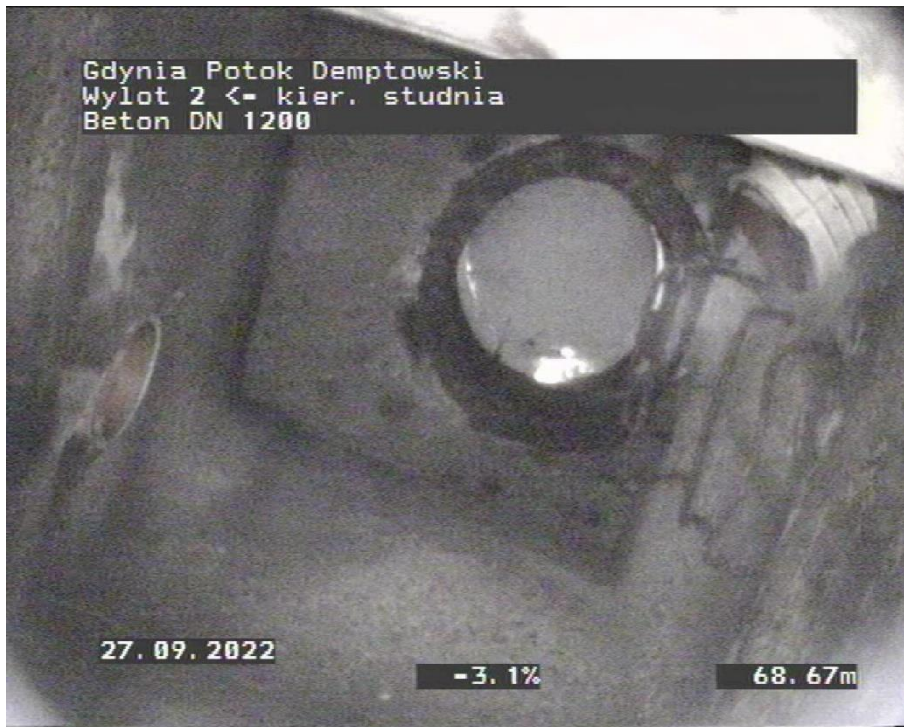
Rysunek 34. Komora na połączeniu rurociągu \varnothing 800 i \varnothing 1000 – komora znajduje się w pasie zieleni pomiędzy jezdniami obwodnicy trójmiejskiej
