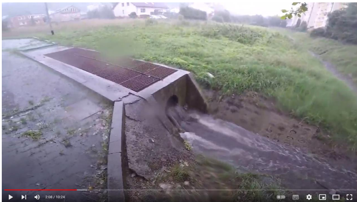
Rysunek 26 Dopyły z kanalizacji deszczowej ul. Demptowskiej w rejonie dawnego Domu Dziecka z dnia 29-09-2022 r. (dzięki uprzejmości p. J. Rogaczewskiego)
